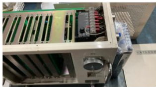
▲ATS受信器内蔵電源取替
